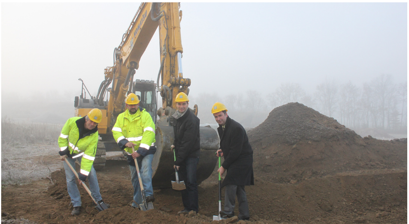
Spatenstich: Mit der Erschließung des neuen Bauabschnitts des Gewerbegebiets Fröhstockheim ist begonnen worden. Martin Pfeuffer vom gleichnamigen Bauunternehmen, Sven Gutjahr (Polier auf der Baustelle) sowie Markus Henneberger vom Ingenieurbüro BAURCONSULT und Bürgermeister Burkhard Klein haben die Arbeitsgeräte symbolisch in die Hand genommen. Foto: Georg Appold
