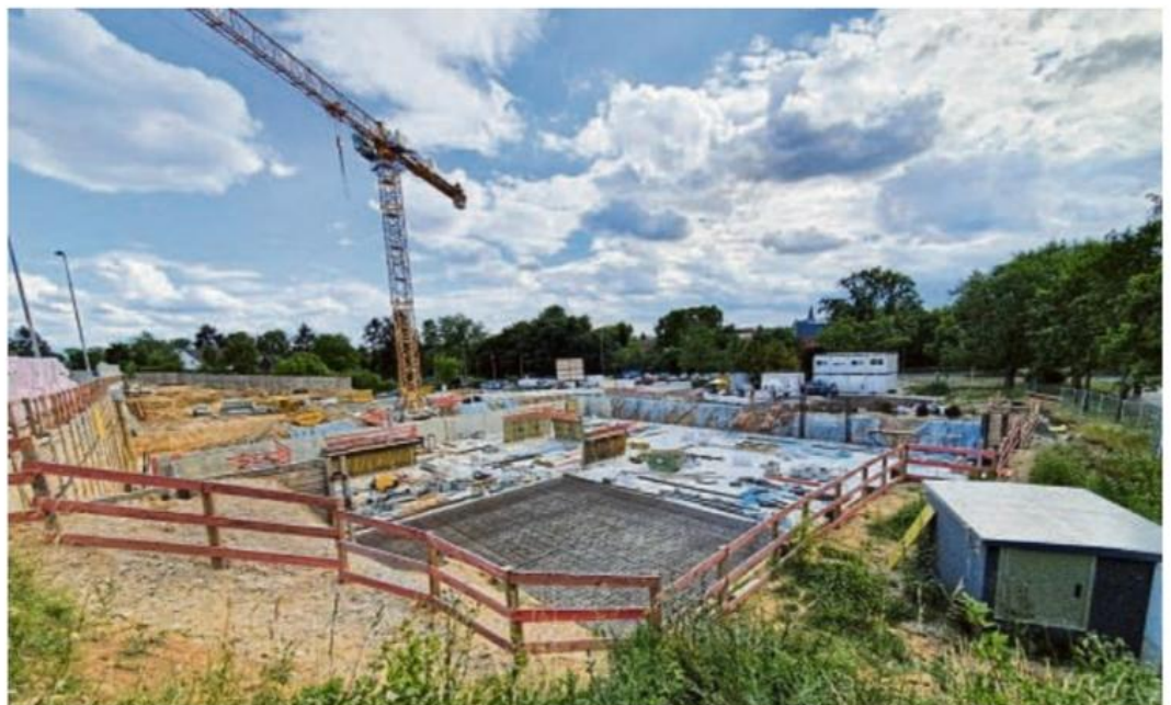
Die Bodenplatte des Sportzentrums ist zu drei Vierteln gegossen, im Bereich der späteren Umkleiden werden schon die Verschalungen aufgebaut. Ende des Jahres soll der Rohbau stehen.
