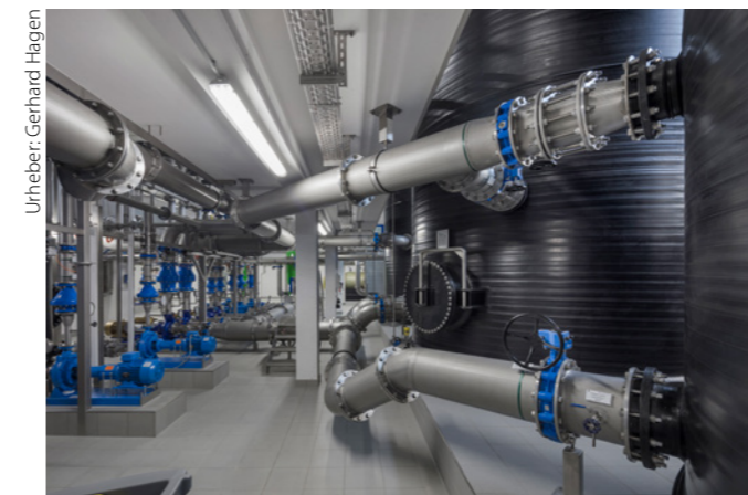
PE-Zwischenbehälter mit Entnahme- und Übereichleitungen
