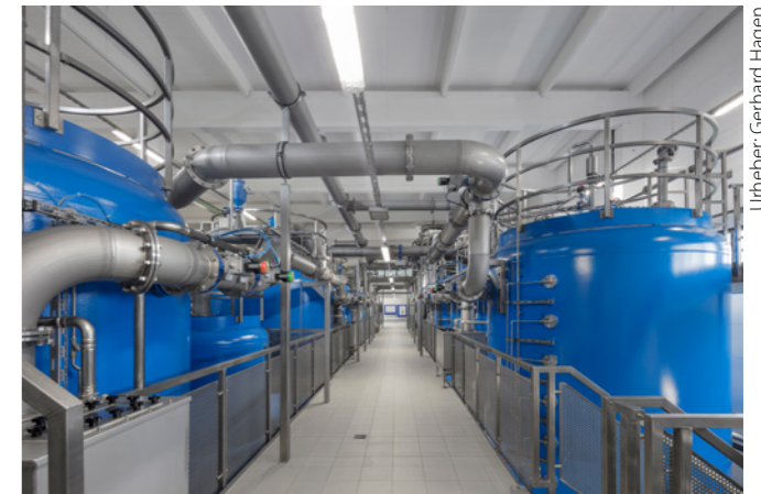
Bediengang Filterhalle mit Enteisierung-, Entmanganungs- und Aktivkohlefilter
