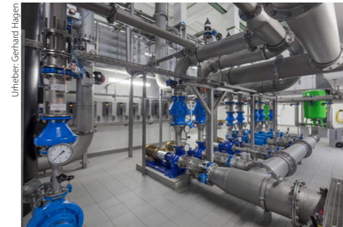
Pumpengalerie im UG für Rückspülung und Förderpumpen
