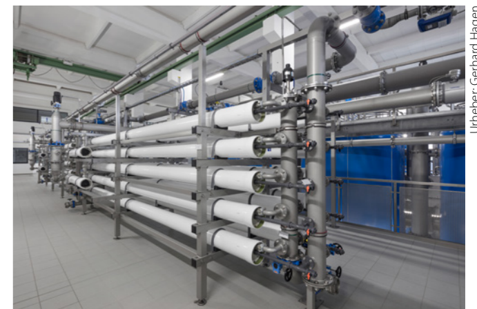
Dreistraßige Nanofiltration im EG (Druckmembrananlage)
